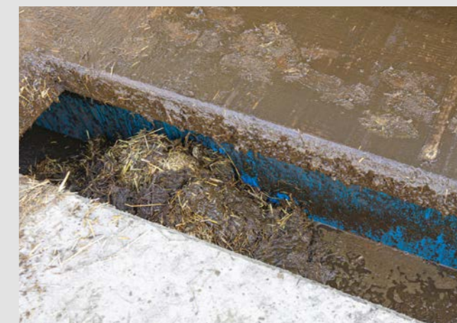
Der Mist wird mittels Schieber über die Öffnung in den JGS®-Pumpenschacht eingebracht.
