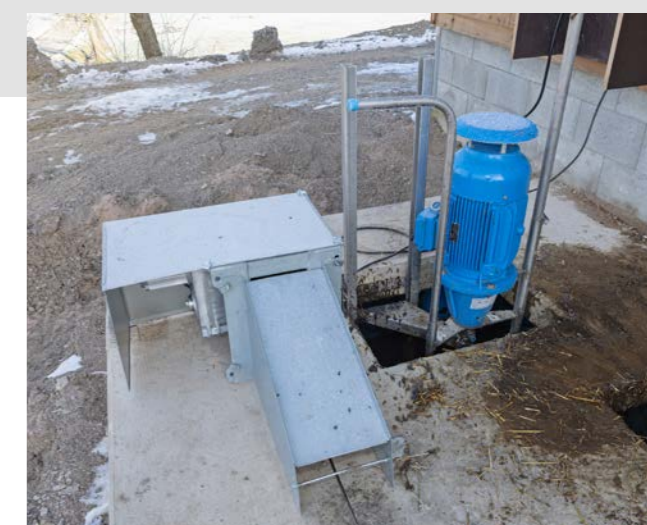
Technik für Pumpe, Rührwerk und Schlitten
